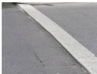
Avant : détail d'un raccord non traité entre la chaussée et le plateau, générant un bruit impulsionnel.
